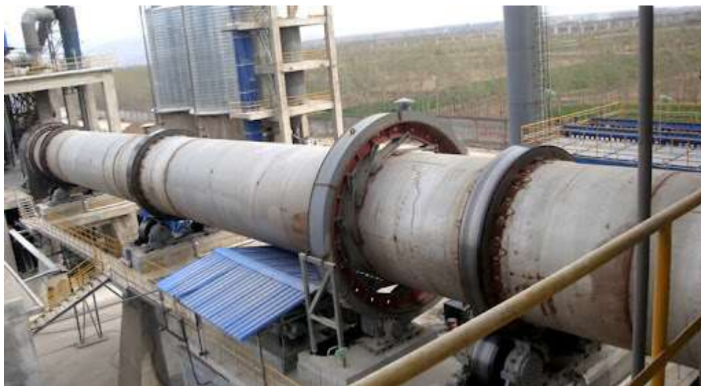
Slika 1. Prikaz rotacijske peći 1 za proizvodnju portland cementa
