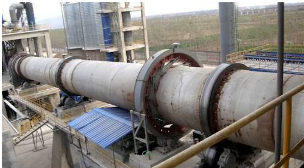
Slika 1. Prikaz rotacijske peći 1 za proizvodnju portland cementa
