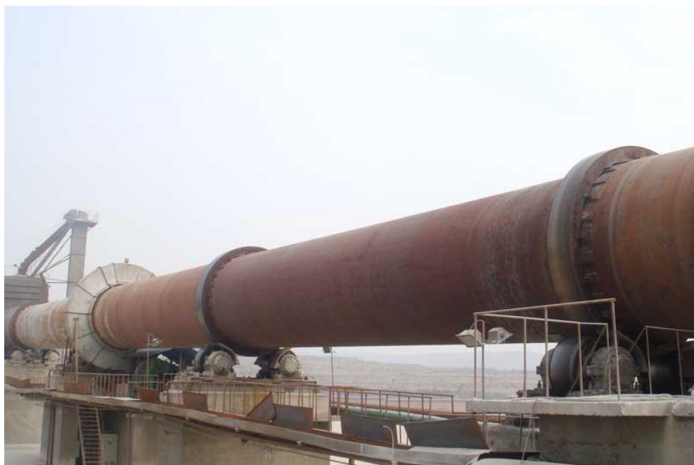
Slika 1.2. Rotacijska peć za proizvodnju cementa 2
