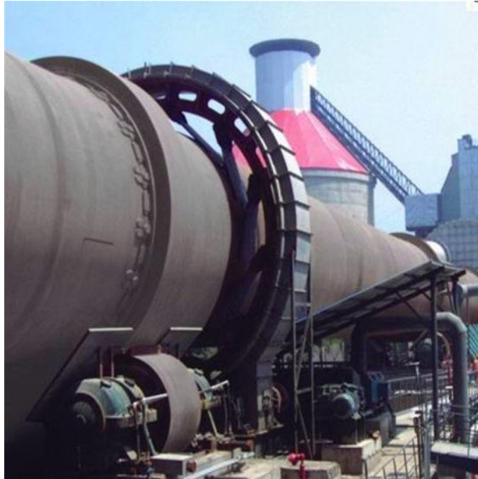
Slika 1.3. Klizni ležajevi rotacijske peći 5
