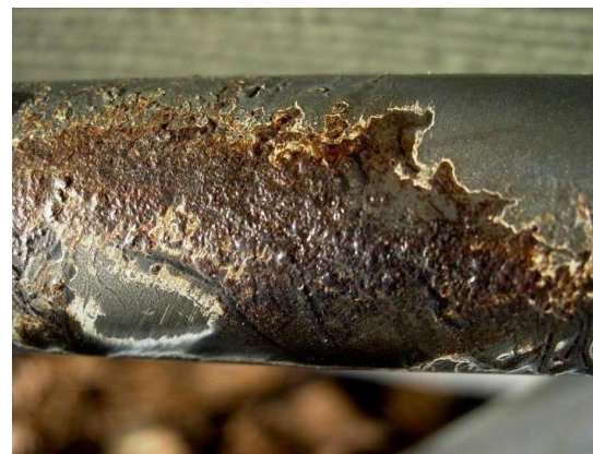
Slika 1.11. Prikaz rupičaste korozije na metalnoj cijevi 26
