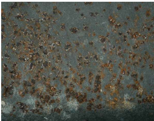
Slika 1.10. Prikaz rupičaste korozije na čeliku 25
