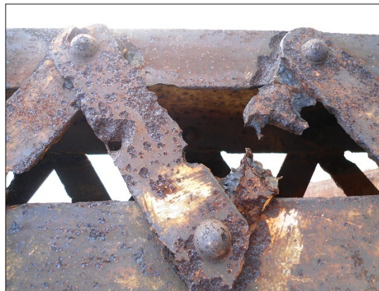
Slika 5.) Korozija na konstrukciji mosta
