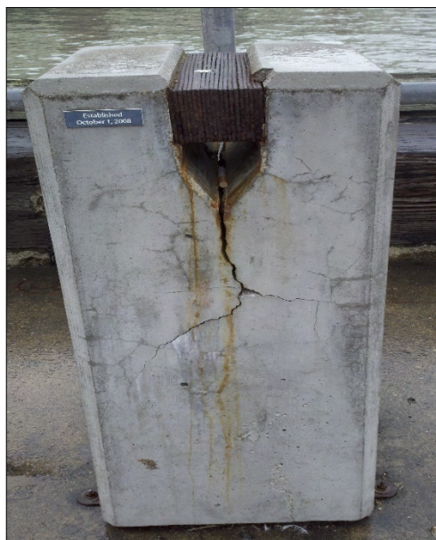
Slika 6.) Korodirani klin, postavljen za demonstraciju sile kojom hrđajuće željezo prilikom širenja može djelovati
