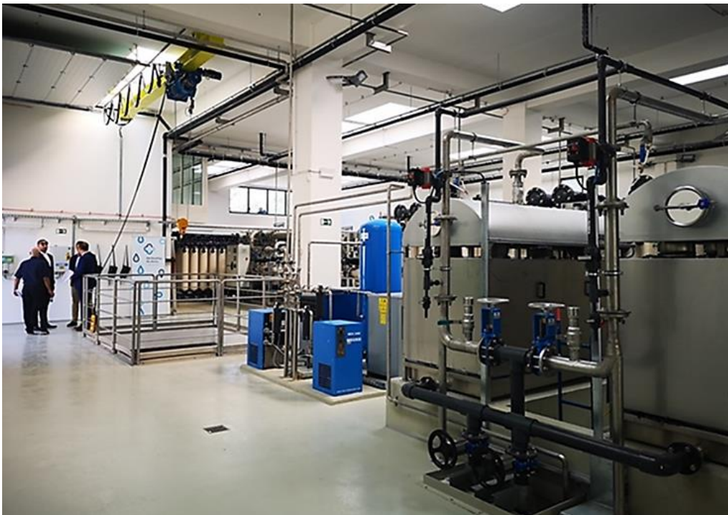
Slika 22. Uređaj za pročišćavanje pitke vode UPPV Komolac .
