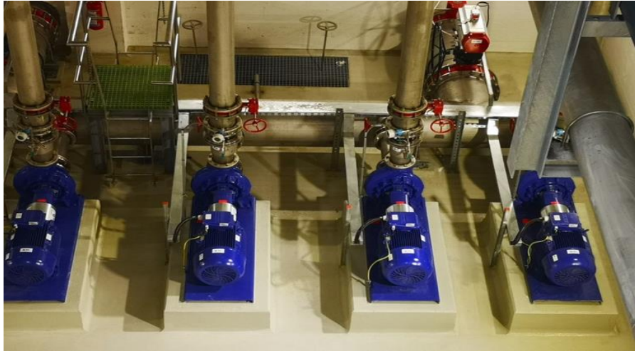
Slika 27. Centrifugalne crpke pomoću koji se voda odvodi na mehaničku filtraciju.
