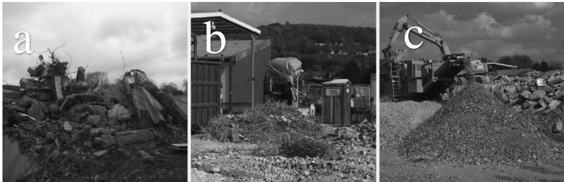
Slika 7. Stanja betona tijekom procesa recikliranja: beton nakon rušenja (a), razdvojene jezgrene žice (b), šljunak od betona (c). 6
