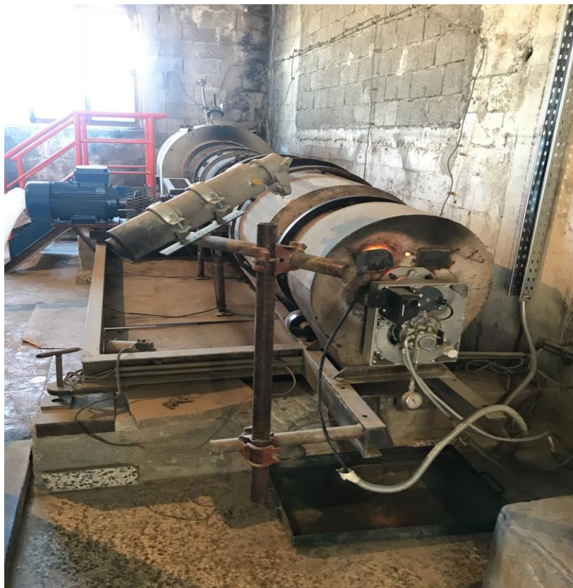
Slika 22. Dizalica goriva i rotacijska peć, frontalni prikaz.
