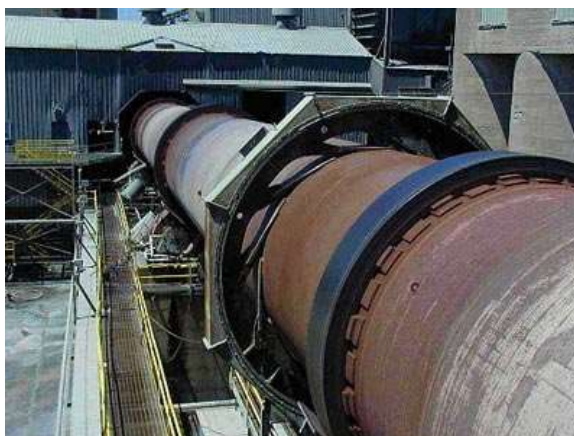
Slika 4. Klizni ležajevi rotacijske peći 5
