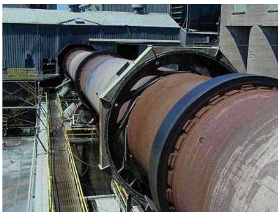
Slika 4. Klizni ležajevi rotacijske peći 5
