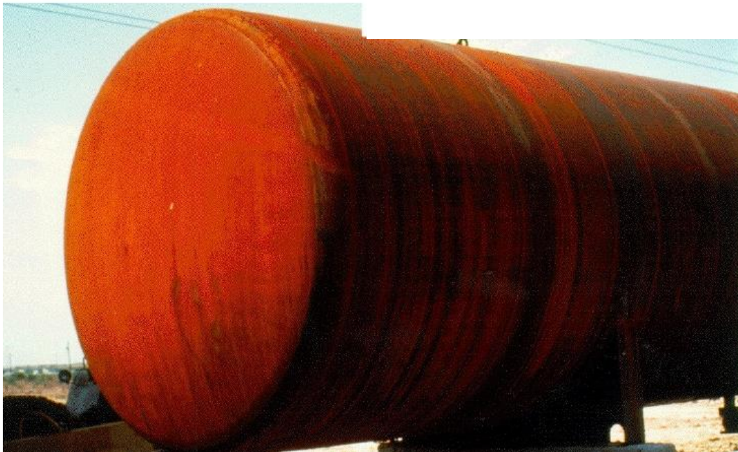
Slika 13. Opća korozija spremnika
