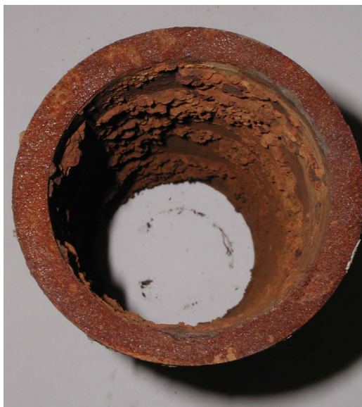
Slika 2.12. Unutarnji izgled lijevano željezne vodovodne cijevi 42 .
