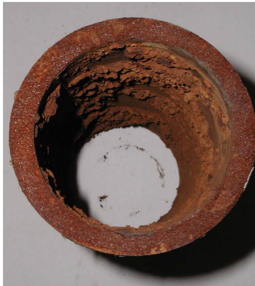
Slika 2.12. Unutarnji izgled lijevano željezne vodovodne cijevi 42 .
