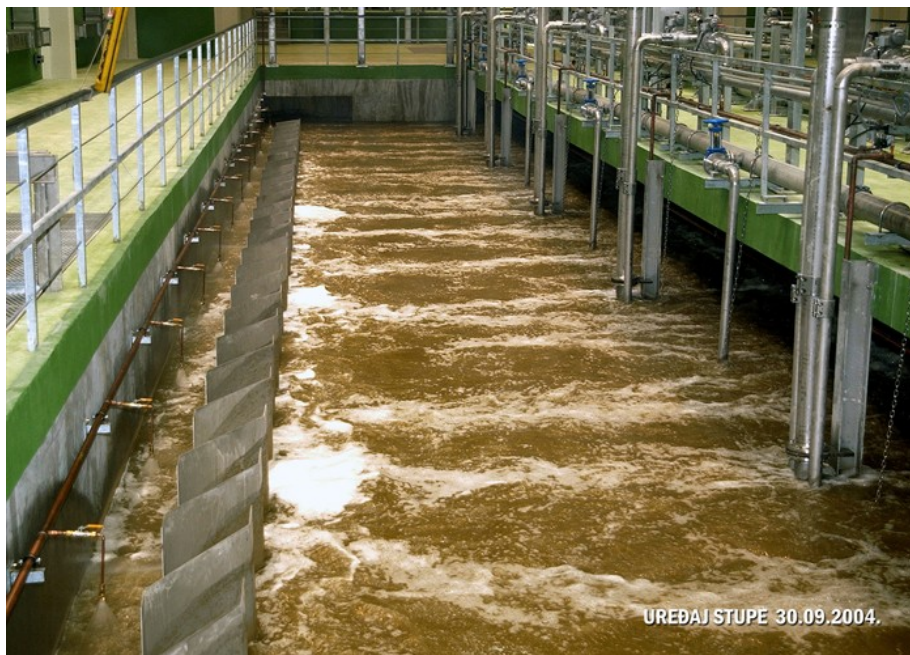
Slika 13. Uređaj za pročišćavanje otpadnih voda Stupe
