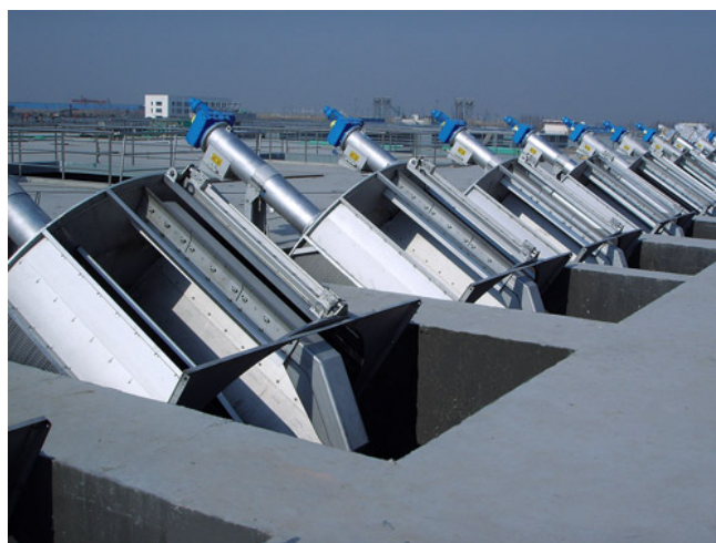
Slika 6. Prikaz fine rešetke HUBER ROTAMAT® Fine Screen Ro1 kao polifunkcionalne zasebne jedinice u procesu obrade otpadne vode – izdvajanje, pranje, sabijanje i transport materijala
