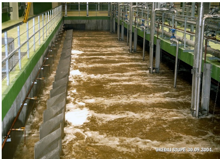
Slika 13. Uređaj za pročišćavanje otpadnih voda Stupe
