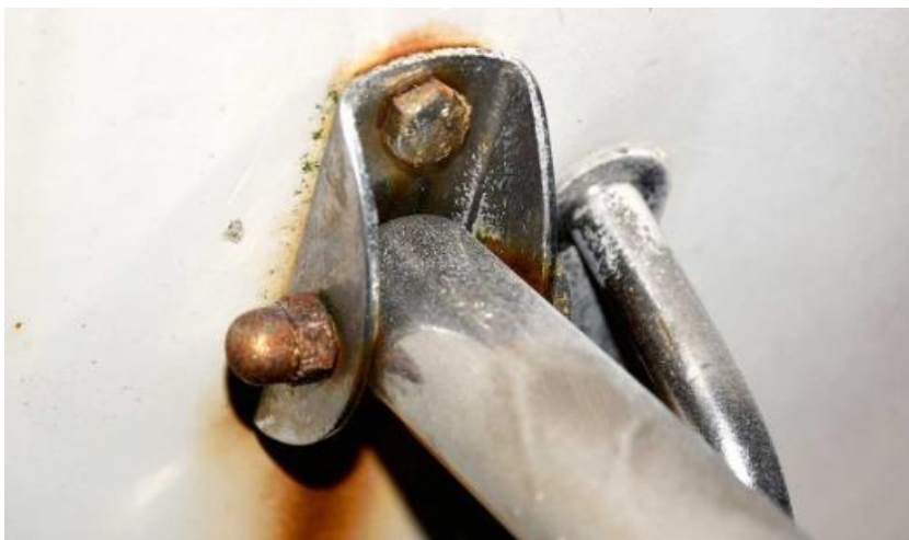
Slika 8. Primjer galvanske korozije. 17
