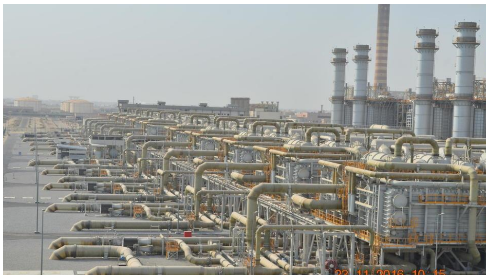
Slika 14. MED postrojenje Az Zour nord et sud, Kuvajt 19
