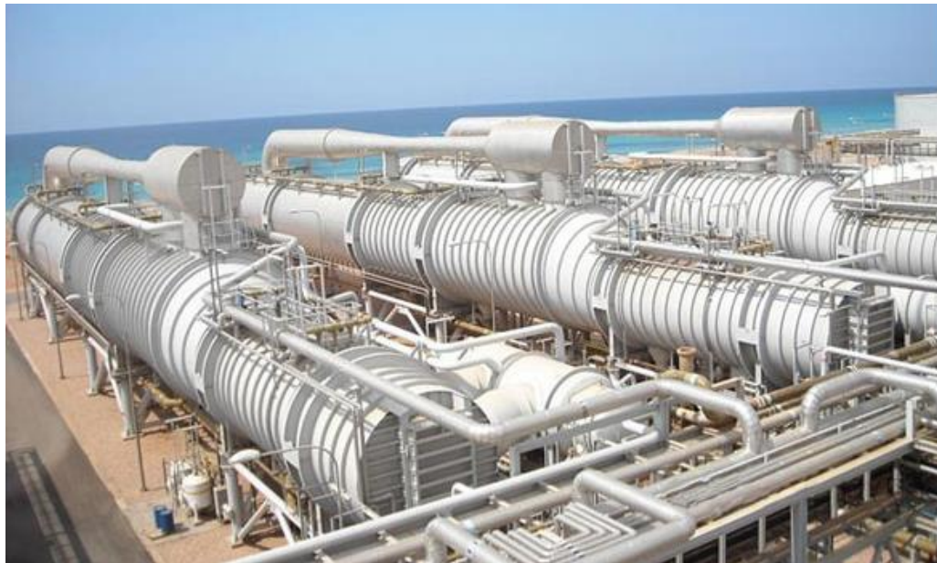
Slika 18. MED-TVC desalinizacijsko postrojenje Abutaraba, Libija 21
