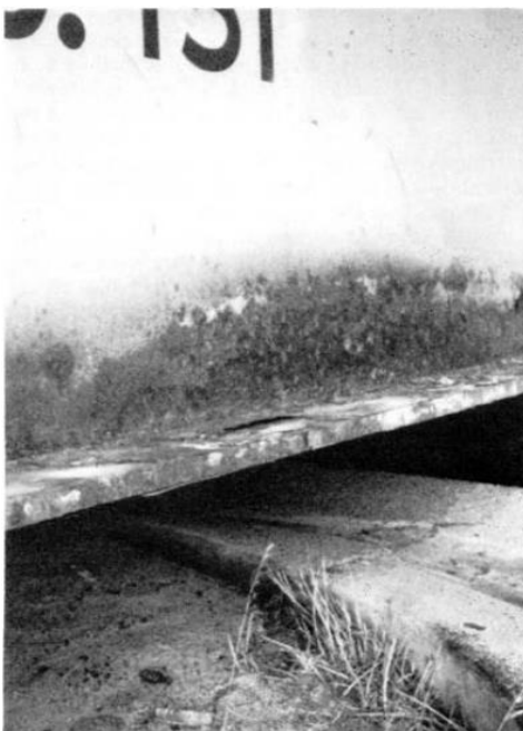
Slika 6. Opća korozija (hrđanje) čeličnog nosača mosta autoceste koji je izložen vremenskim utjecajima. 1
