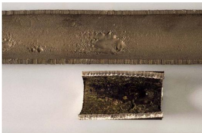
Slika 4. Erozijska korozija CuNi legure 25
