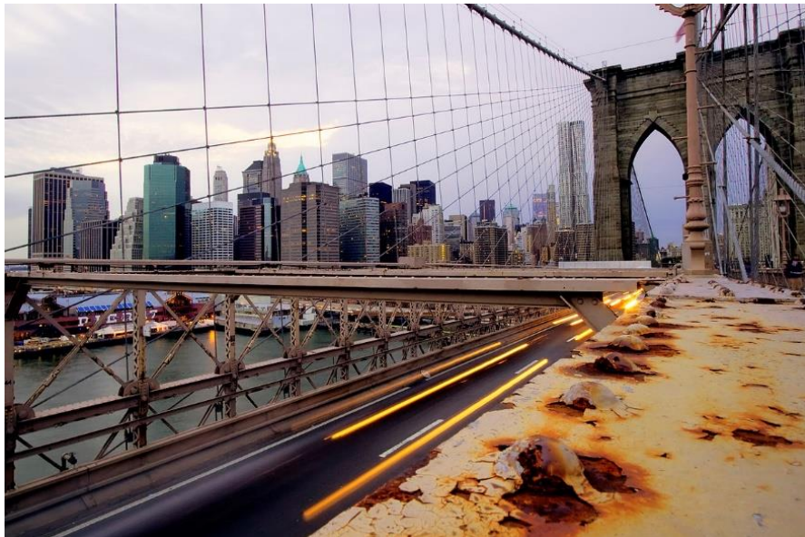
Slika 1.5. Korozijsko djelovanje na konstrukcijskim građevinama svjetskih gradova.
