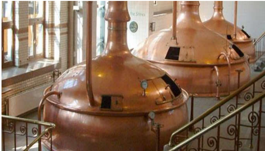
Slika 1.3. Kotlovi za kuhanje sladovine 14
