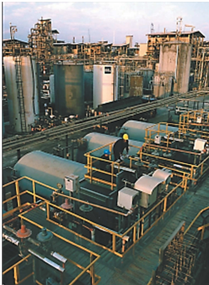
Slika 1.16. Spremnici za skladištenje broma u postrojenju 20
