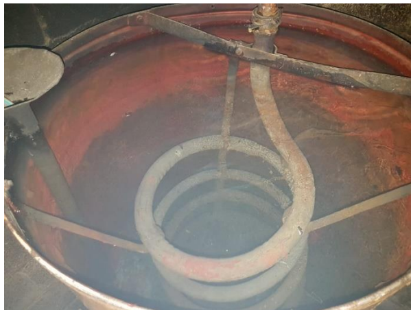
Slika 12. Spiralne bakrene cijevi hladnjaka
