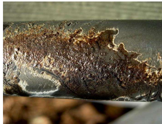
Slika 1.11. Prikaz rupičaste korozije na metalnoj cijevi 26
