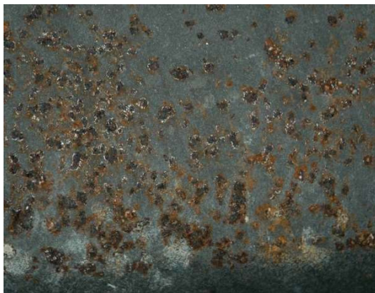
Slika 1.10. Prikaz rupičaste korozije na čeliku 25
