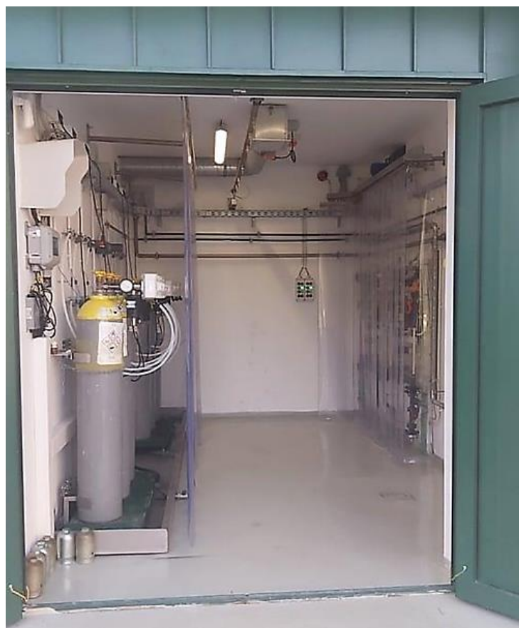
Slika 33. Klorna stanica UPPV Komolac.
