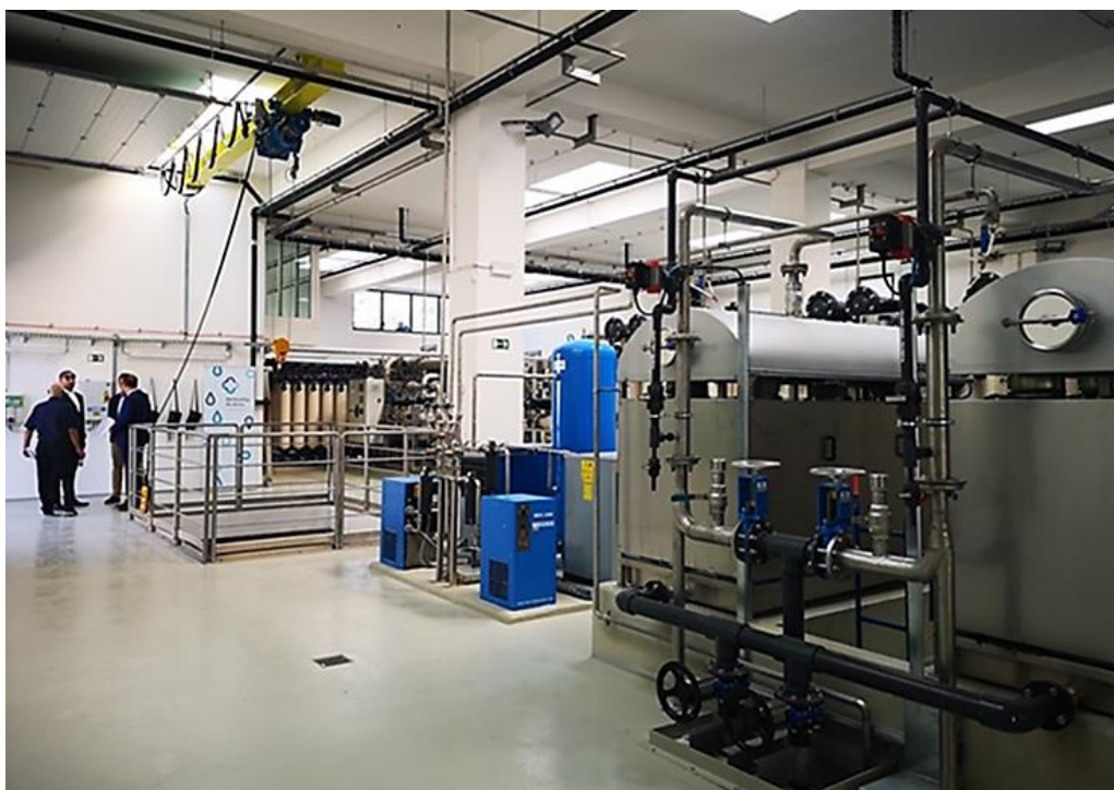
Slika 22. Uređaj za pročišćavanje pitke vode UPPV Komolac .
