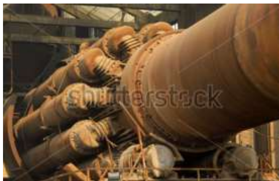
Slika 3. Rotacijska peć – procesna jedinica za proizvodnju klinkera 3
