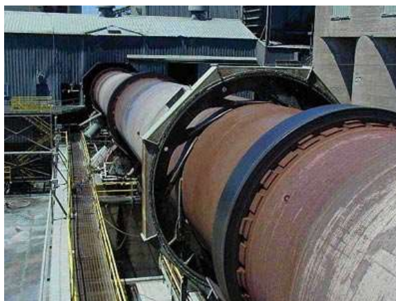
Slika 4. Klizni ležajevi rotacijske peći 5
