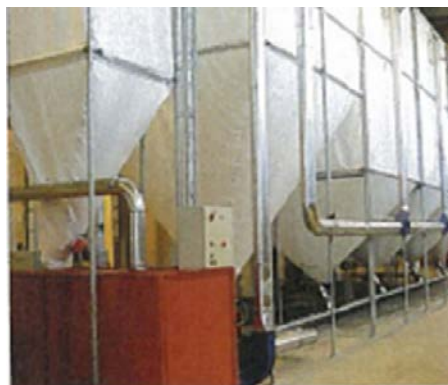
Slika 11. Silosi za stabilizaciju granula stiropora 14
