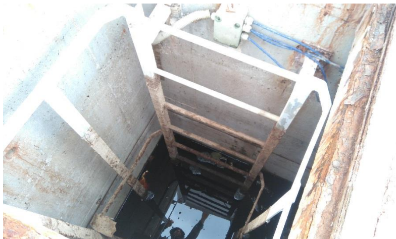
Slika 2.1 Egalizacijski bazen odlagališta otpada RCGO Bikarac.
