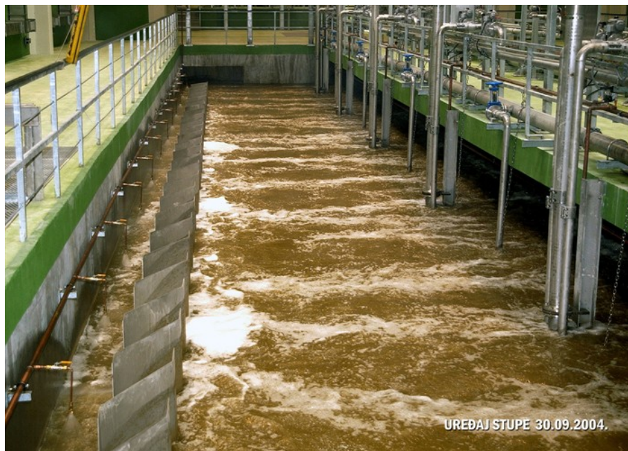
Slika 13. Uređaj za pročišćavanje otpadnih voda Stupe
