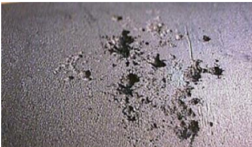
Slika 9. Primjer rupičaste korozije. 18
