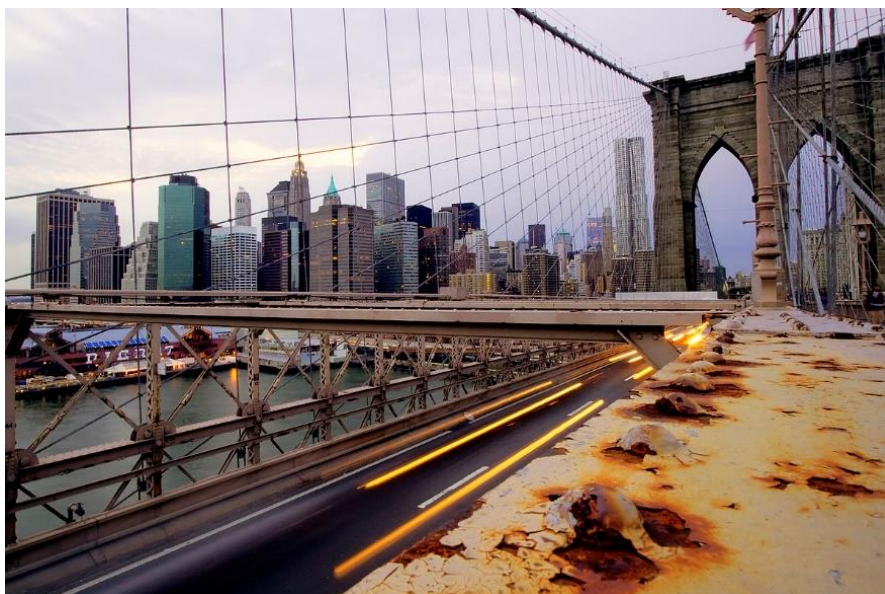
Slika 1.5. Korozijsko djelovanje na konstrukcijskim građevinama svjetskih gradova.
