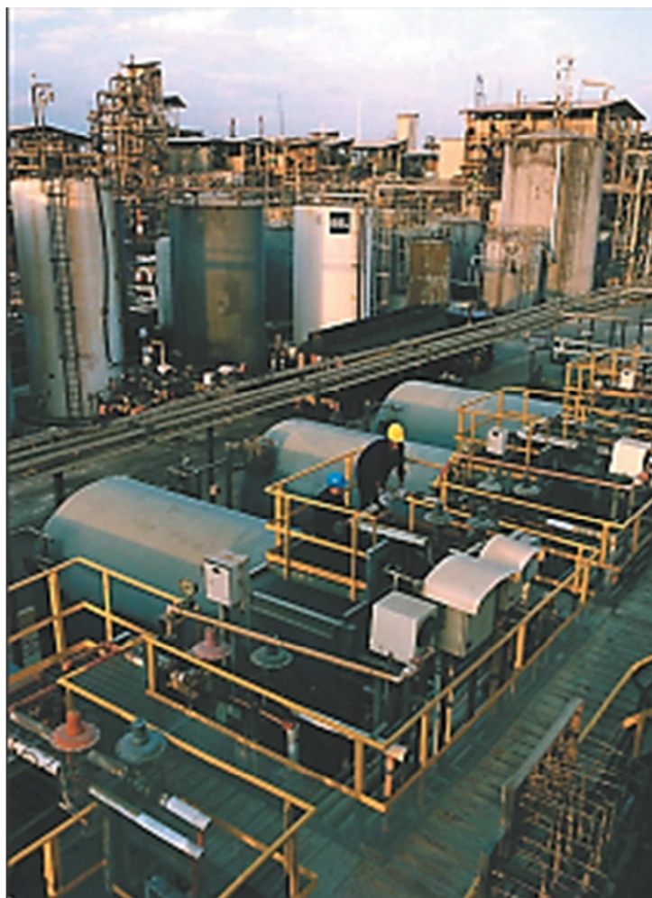
Slika 1.16. Spremnici za skladištenje broma u postrojenju 20
