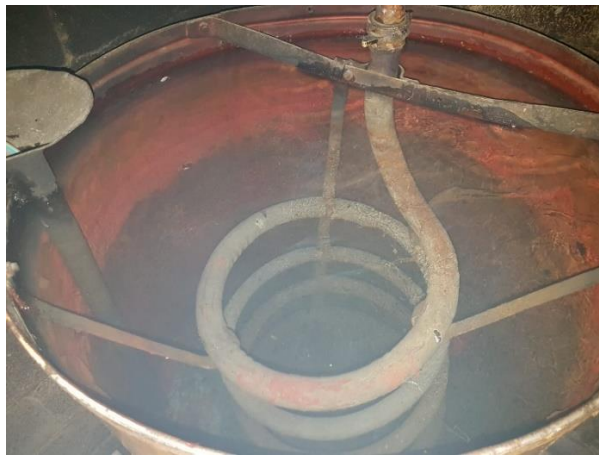
Slika 12. Spiralne bakrene cijevi hladnjaka
