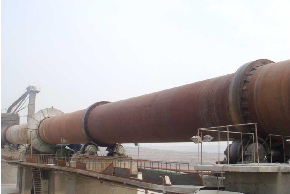
Slika 1.2. Rotacijska peć za proizvodnju cementa 2
