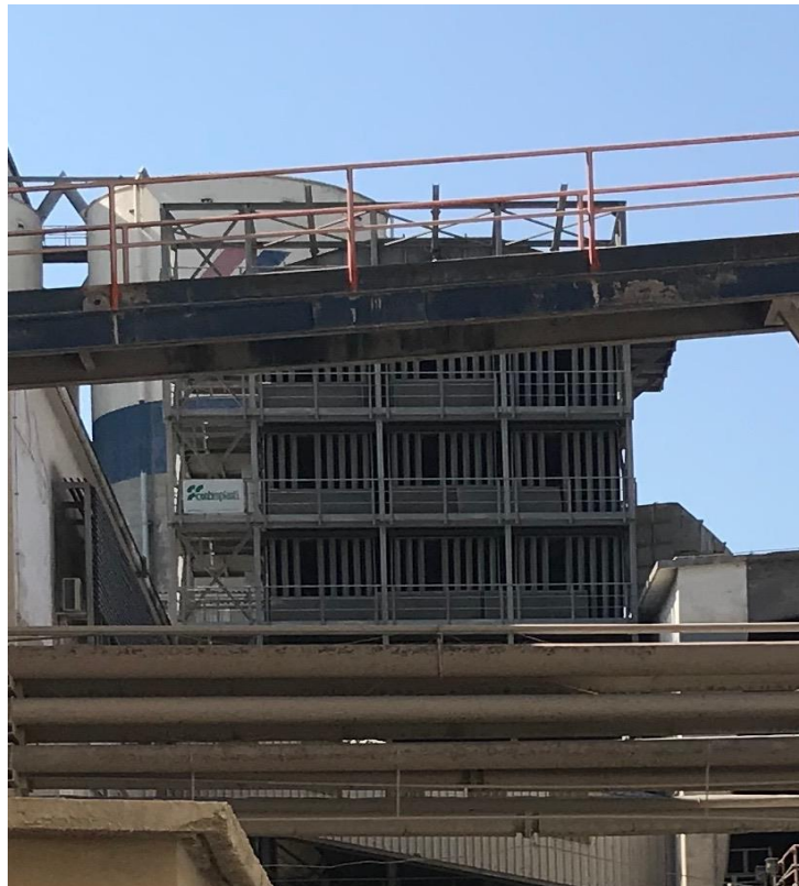
Slika 8. Hladnjak za hlađenje klinkera u tvornici Sv. Kajo
