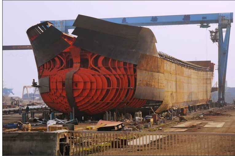
Slika 3.) Teretni brod u izgradnji. Na slici su vidljive čelične komponente trupa: okvir i ploče
