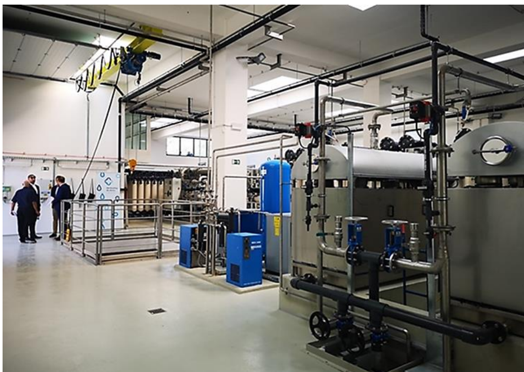
Slika 22. Uređaj za pročišćavanje pitke vode UPPV Komolac .
