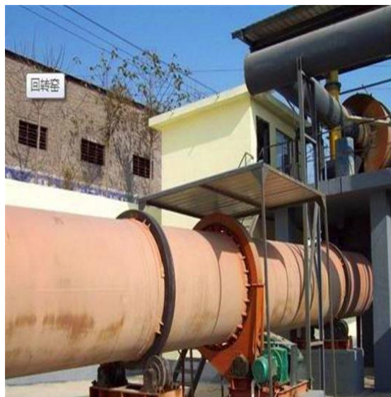
Slika 3. Klizni ležajevi rotacijske peći 3
