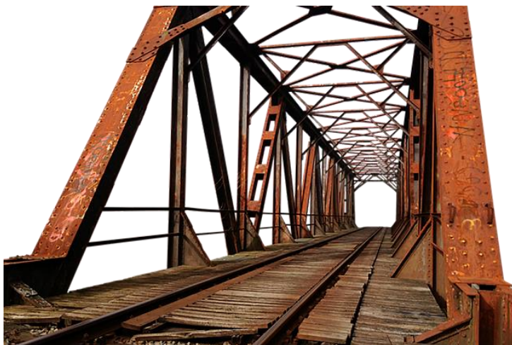
Slika 1. Djelovanje korozije na most 3
