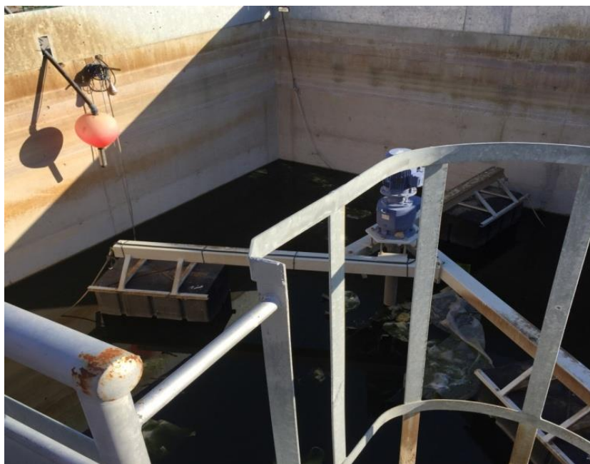
Slika 2.2. Spremnik procjednih otpadnih voda odlagališta otpada RCGO Bikarac
