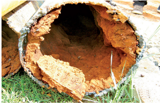
Slika 2.4. Inkrustacije željezovih oksida 23 .
