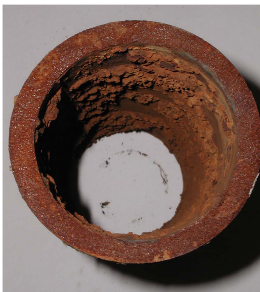
Slika 2.12. Unutarnji izgled lijevano željezne vodovodne cijevi 42 .
