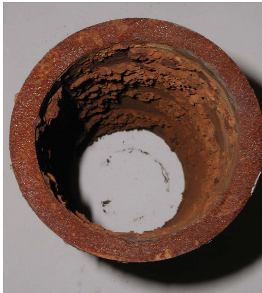
Slika 2.12. Unutarnji izgled lijevano željezne vodovodne cijevi 42 .
