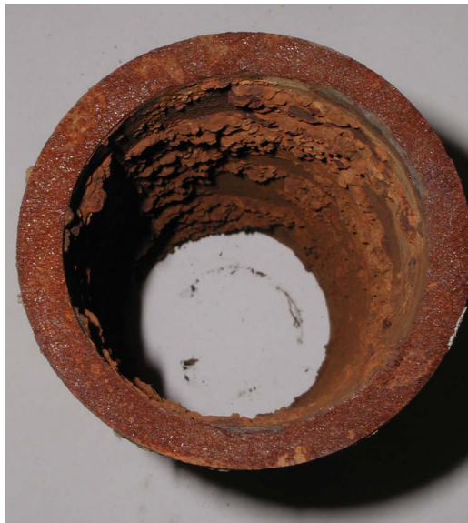
Slika 2.12. Unutarnji izgled lijevano željezne vodovodne cijevi 42 .
