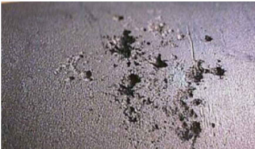
Slika 9. Primjer rupičaste korozije. 18
