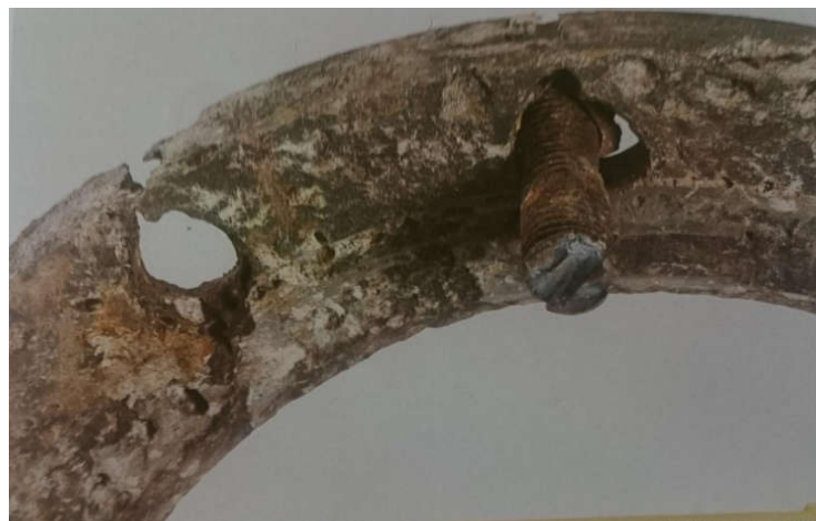
Slika 1.13. Galvanska korozija aluminijske legure 26
