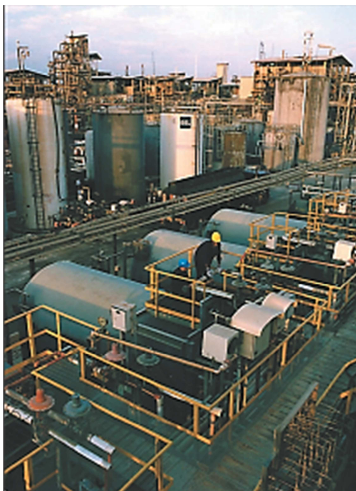
Slika 1.16. Spremnici za skladištenje broma u postrojenju 20
